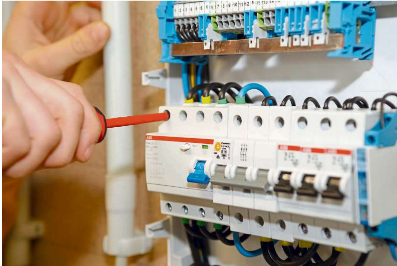
Arbeiten am Sicherungskasten sind für Laien nicht nur gefährlich – bei nicht fachgerechter Installation zahlt auch die Versicherung nicht für Schäden.
