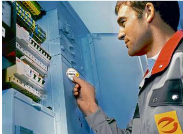
Nach der Prüfung gibt es die Plakette: Der Aufkleber am Sicherungskasten signalisiert, dass die elektrische Anlage im Haus vom Fachmann geprüft wurde.
